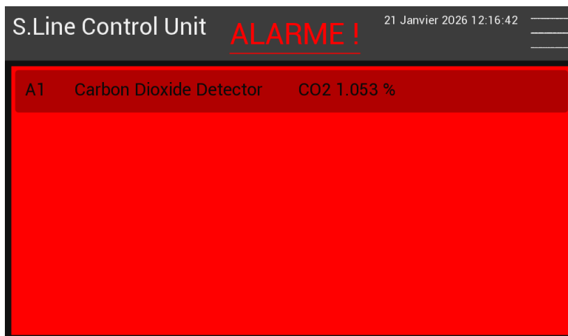
Figure 20 – Écran d'accueil en état d'alarme
